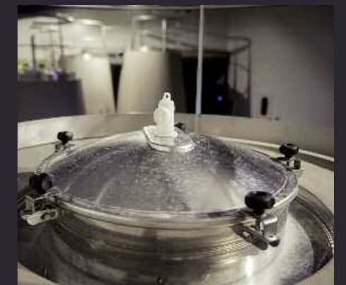
Double cheminée avec évacuation dans pieds de cuve
